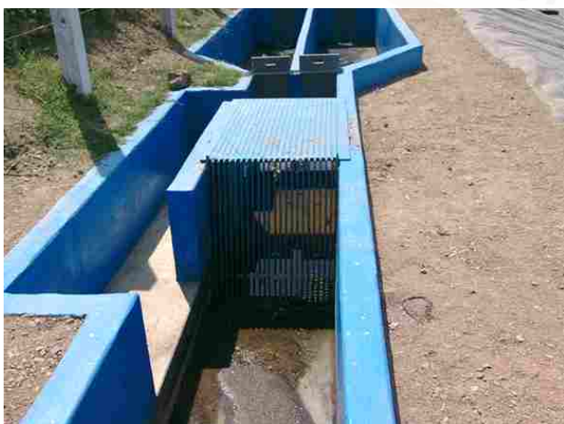
Figura 3. Rejas de desbaste y desarenador de la PTAR de Quilmaná.
